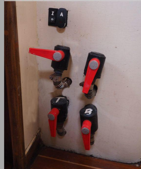
Vannes citernes eau directement accessibles vanne douche et sortie eau de mer nettoyage cockpit commande pompe de cale
